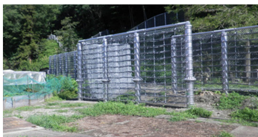
2号崩壊土砂防止柵
